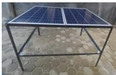
Gambar 2. Meja dudukan sistem pompa air tenaga surya, sel surya terpasang.
