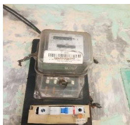
Gambar 4. kWh meter yang disadap dengan menggunakan kabel jumper
