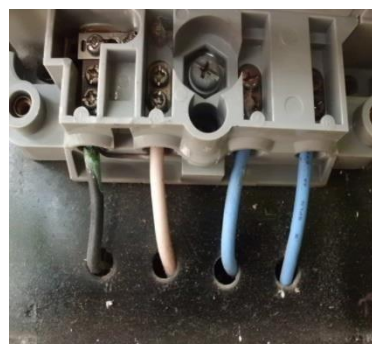
Gambar 3. MCB yang telah diganti sesuai dengan Daya Pemakaian
