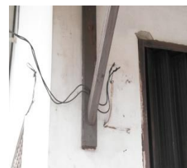
Gambar 5. Pemakaian Energi Listrik tanpa KWH Meter
