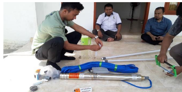
Gambar 5. Instalasi Pompa Celup
