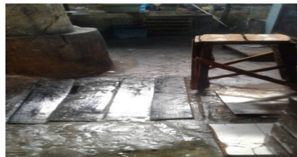
Gambar 3. Kondisi Lantai yang Licin
